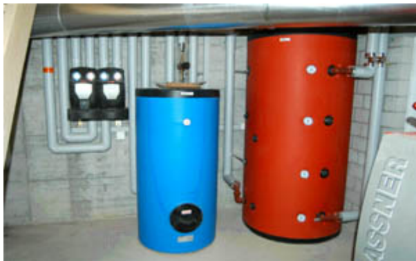
Technischer Pufferspeicher (rot)
